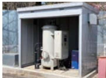
50m 3 /日 福祉施設 (小型ろ過ユニット/埼玉県)
