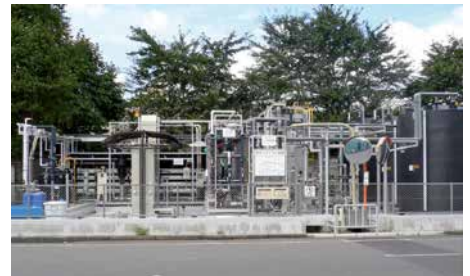
▲RO膜ろ過：処理水量 860m³/日（神奈川県相模原市）
