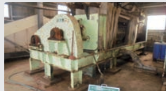
脱水設備整備・更新
