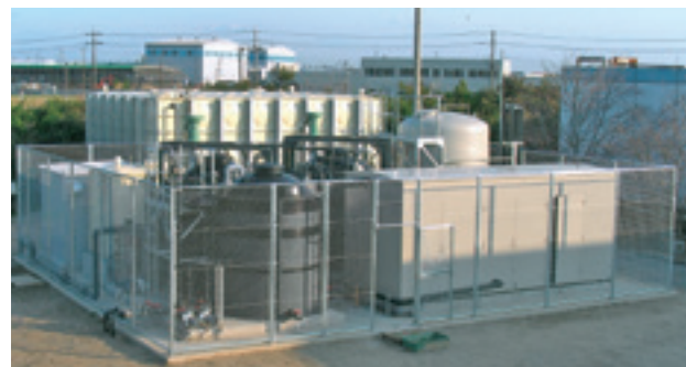
食肉加工場[千葉県] 1,700m 3 /日 造水プラント（RO膜ろ過）
