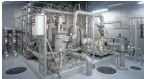
熊本県庁舎〔熊本県〕造水能力 115.6m 3 /日
