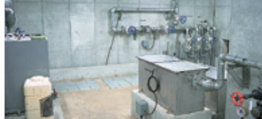
厨房排水/中央合同庁舎[東京都] 処理水量 130m³/日
