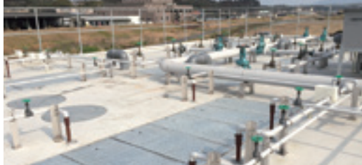
食品加工排水/鹿島食品[鹿児島] 処理水量 300m³/日
