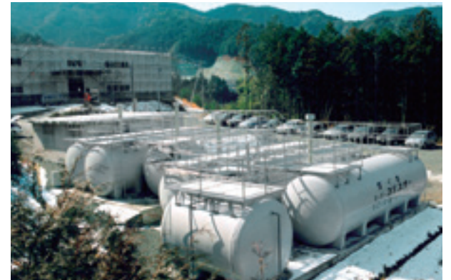
調味料製造工場[愛媛県] 処理水量 100m 3 /日
