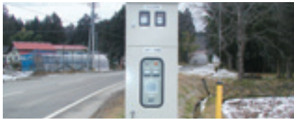
涌谷町 上郡地区（農集排）4号中継ポンプ施設 〔宮城県〕 10ヶ所1.5～11.0kW
