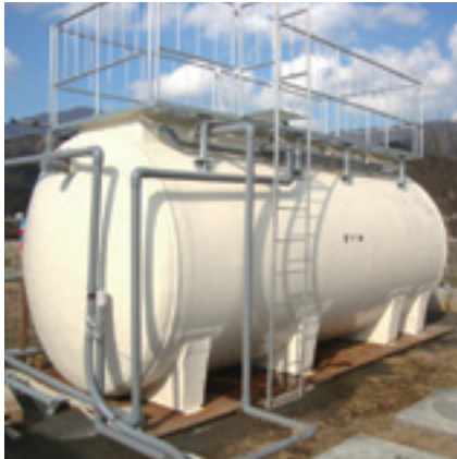
農業集落排水処理施設での使用例
