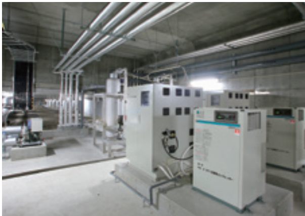
富士山五合目トイレ[山梨県] 処理水量138㎡/日(地下型)
