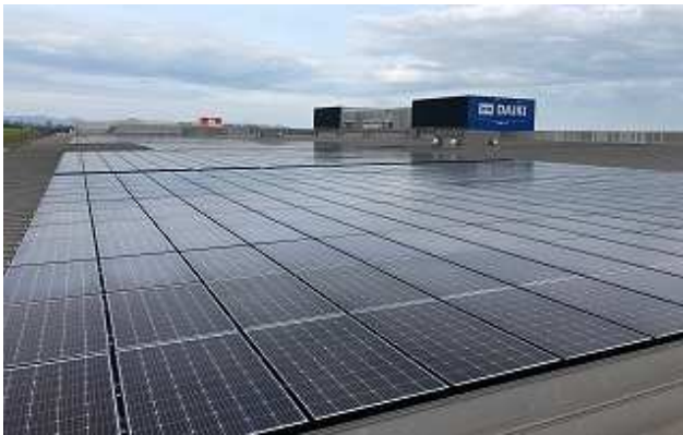
a)ダイキ岡山店(500kW 岡山県岡山市 2018/8 連系)
